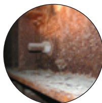
La rouille et la corrosion
