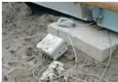
L'élimination des boîtes de jonction a supprimé la cause la plus commune des pannes sur un pont-bascule.
