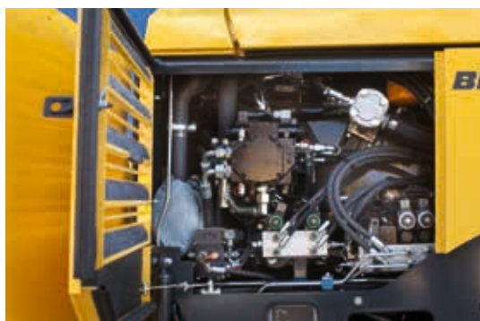
Bon accès à : - l'hydraulique centrale - Pompes - Vannes - Raccordements
