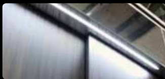
Eclairage portes LED intégré dans le châssis (seulement avec portes automatiques)
