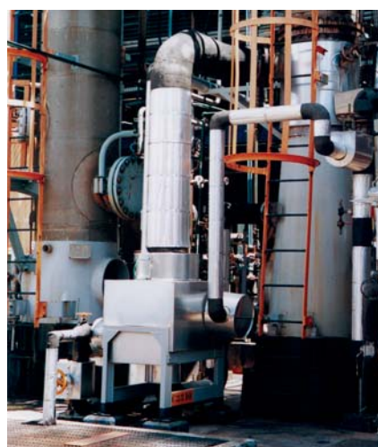
Compabloc installé comme rebouilleur en colonne de distillation dans une usine d'acétate d'éthyle de Rhodia, implantée au Brésil
