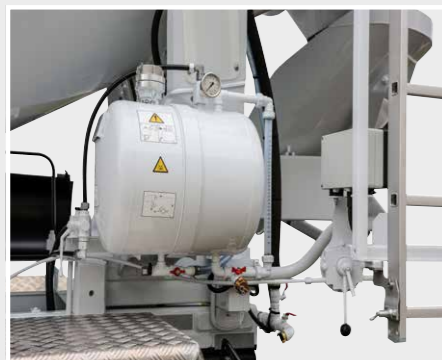
Installation pour fluidifiant 60 l (air comprimé)
