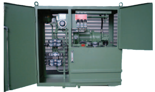
Réservoir intégré dans une armoire
