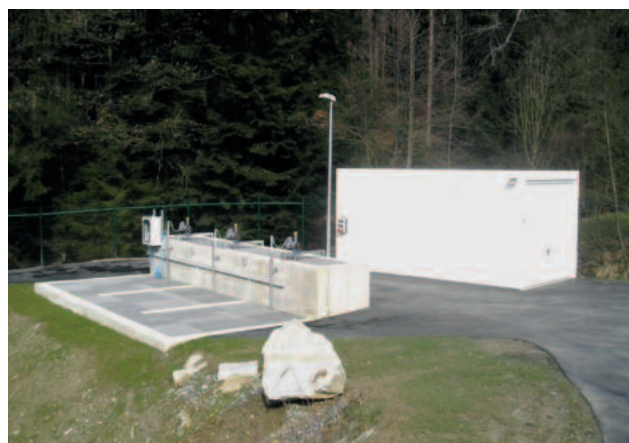
Filtre à sable CONTIFLOW® CFSF 50C, Salzweg, Allemagne
