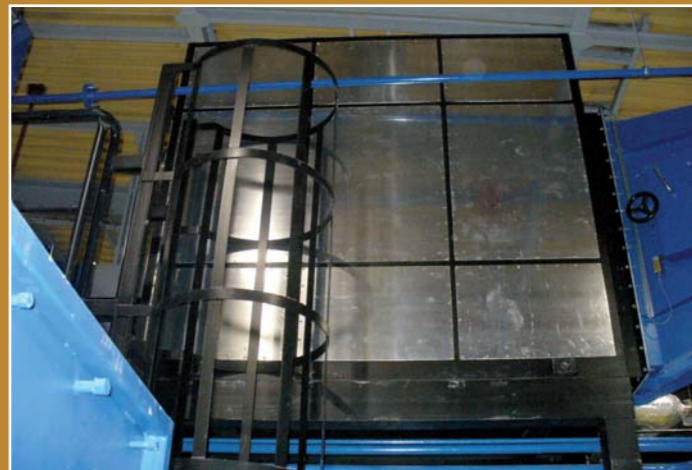
Chaudière à vapeur / Steam boiler
