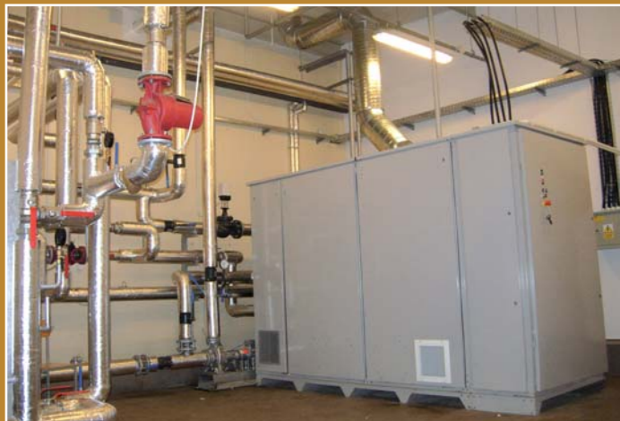
Générateur électrique / Electric generator
