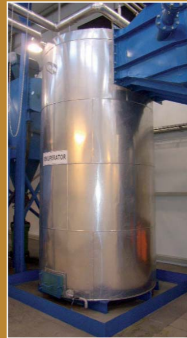
Chaudière à eau chaude Hot water boiler
