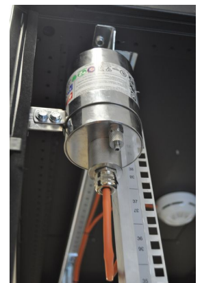
Aérosol implanté dans une baie informatique
