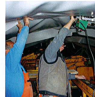
COMET à l'œuvre dans les tunnels ...
