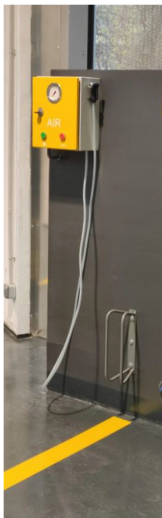
Figure 1: Station de gonflage - vue générale
