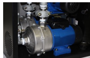
Circuit de refroidissement
