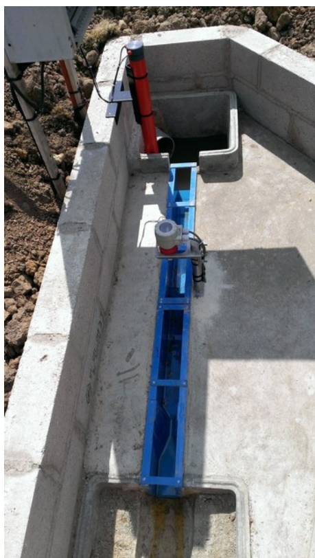
Exemple d'installation avec mesure de niveau/débit et pH
