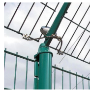
Mise à la terre
