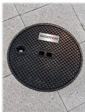
Borne retirée - Regard fermé qui reste en place
