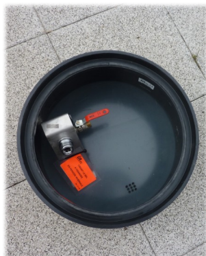
Regard OHSA ouvert et sa vanne
