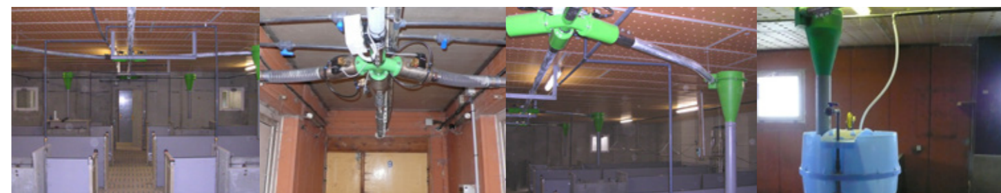
Distribution pneumatique en élevage de porcs
