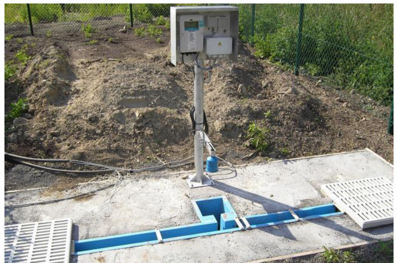
Foto: canal venturi avec unité de mesure par ultrasons
