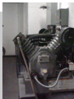
Compresseur d'air - Image visible intégrale
