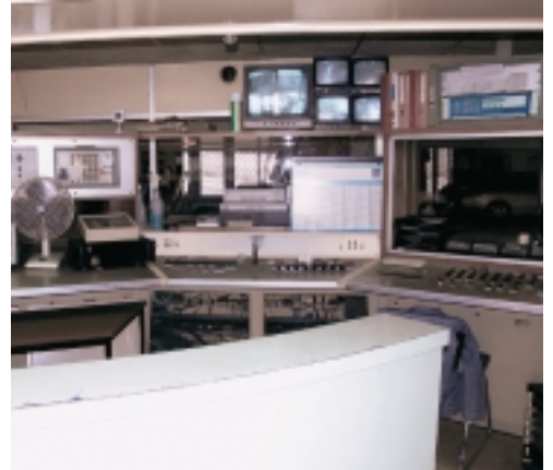
Exemple d'application : salle de contrôle d'un parking souterrain.
