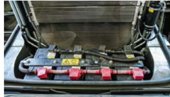
Quatre batteries sans entretien fournissent l'alimentation nécessaire au Fendt 1100 MT.
