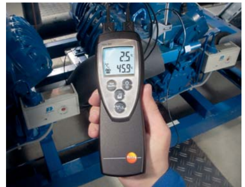
Mesures simultanées des températures de surchauffe et de sous-refroidissement sur une installation frigorifique
