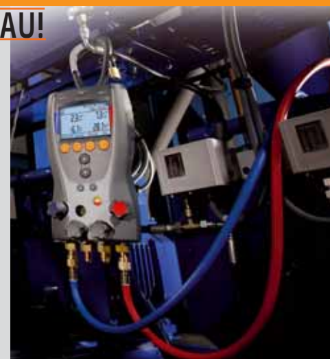
Mise en service, maintenance d'une installation frigorifique
