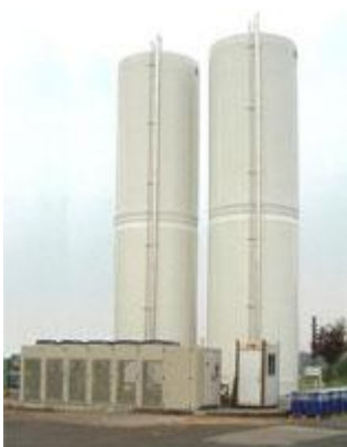
Application agro-alimentaire (550 kW – eau glacée à +3°C)
