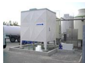
Application refroidissement autoclaves (1500 kW – eau à +25°C)
