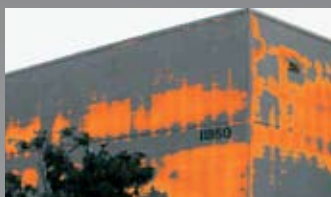
Image mixte, obtenue par la fonction Fusion, montrant les différences de température. Cela indique la présence d'eau et fait apparaître les différences de structure de la construction.
