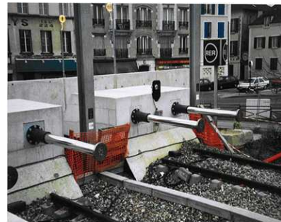
Amortisseurs de chocs dans des blocs bétons
