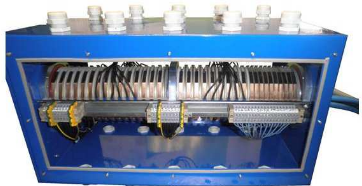
Collecteur Puissance + signal 24V MACHINES SPECIALES
