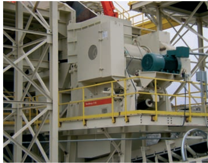
Un C145 pendant la phase d'installation dans une nouvelle unité de concassage primaire.
