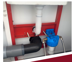
Filtre sur arrivée d'eau
