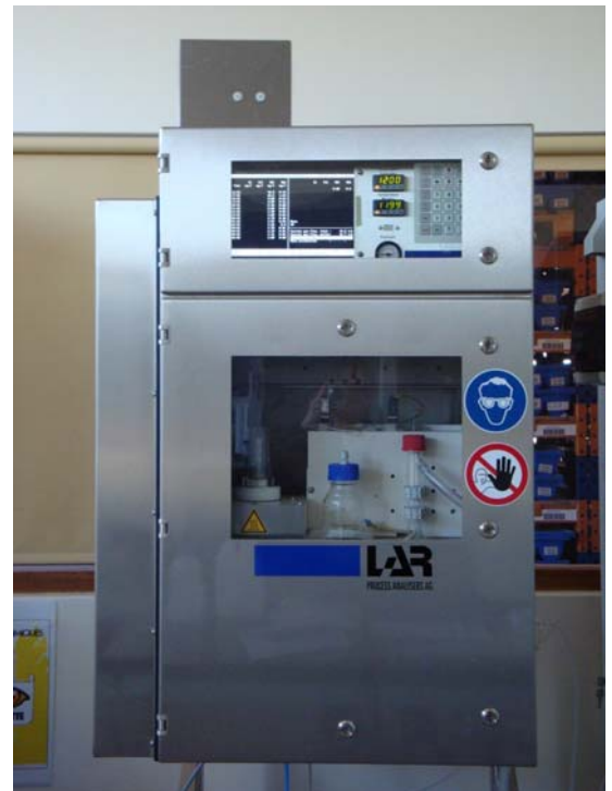
Suivi d'eau souterraine Boitier INOX
