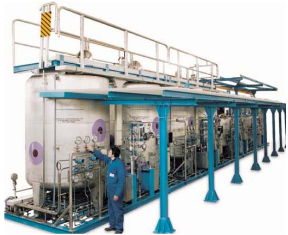
Skid de Dosage Anti-mousse, Anticalcaire, et Sulfate Ferreux et Sulfite de Sodium
