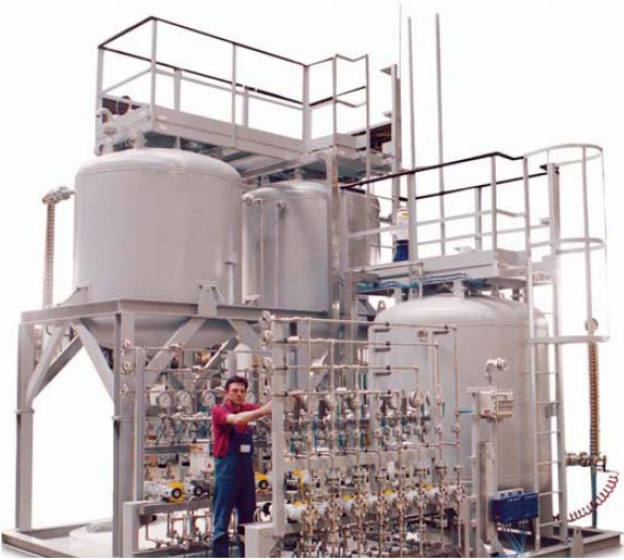
Skid d'Injection Inhibiteur de Glycol et de Corrosion
