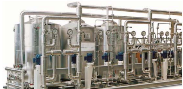
Skid de Dosage de Produits Chimiques
