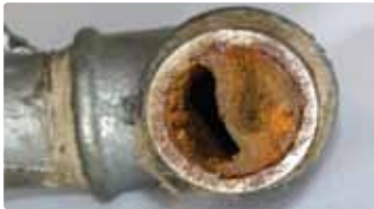
Tuyau présentant des dépôts de calcaire
