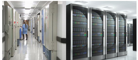
Solutions de secours pour palier les coupures électriques
