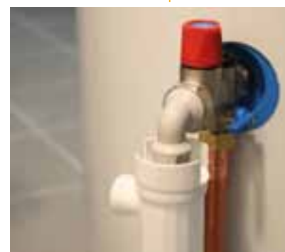
Raccordement eau froide
