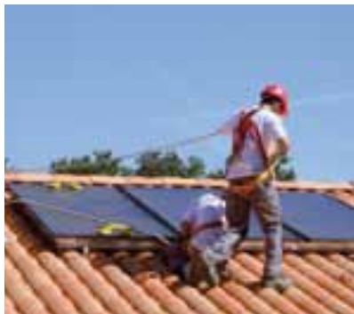
Placement des capteurs
