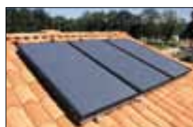
Capteurs posés sur le toit Tuiles
