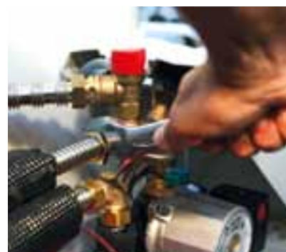
Raccordement du twintube sur la station solaire
