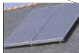
Capteurs posés sur le toit Ardoises
