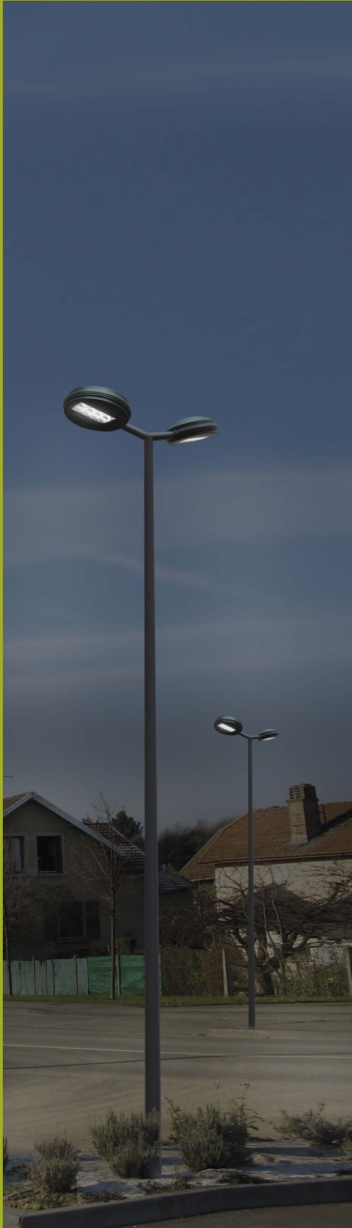
Loo latéral N°2 sur crosse Éridan et mât Féroé
