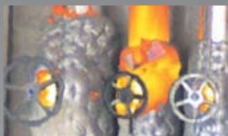
Image mixte, obtenue par la fonction Fusion, d'un échappement de vapeur de la canalisation.
