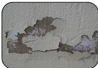
Détérioration due au salpêtre
