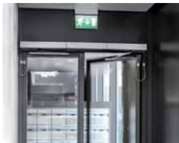
Issue de secours - Désenfumage
