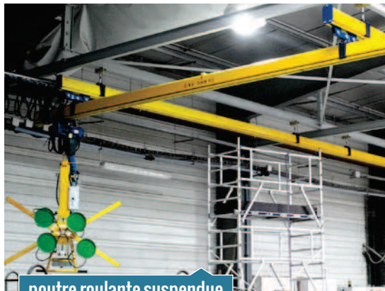
poutre roulante suspendue
