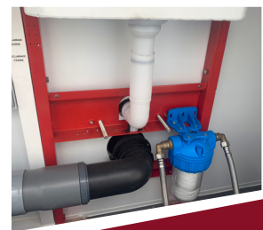
Filtre sur arrivée d'eau
