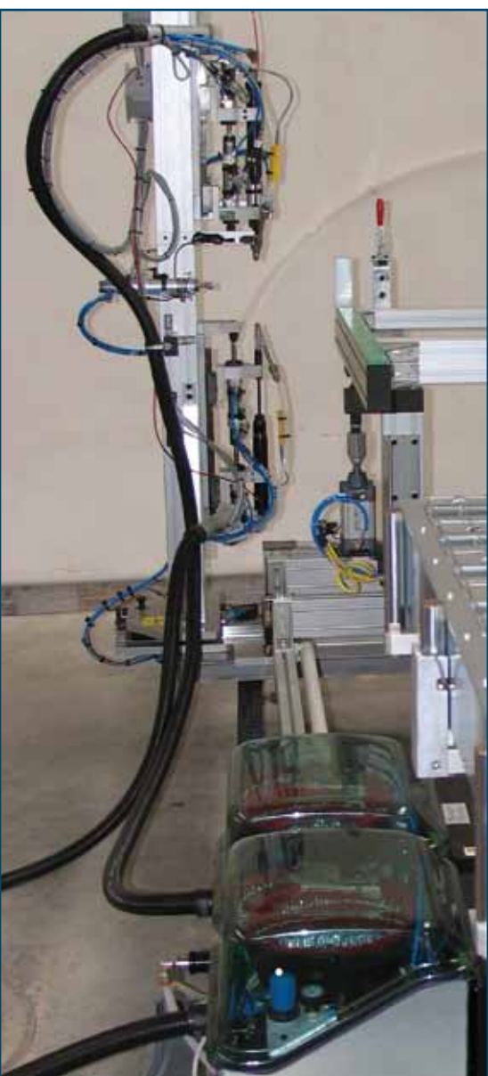
Exemple de MCA multiples pour montage de volets: vissage simultané de haut en bas et de bas en haut
