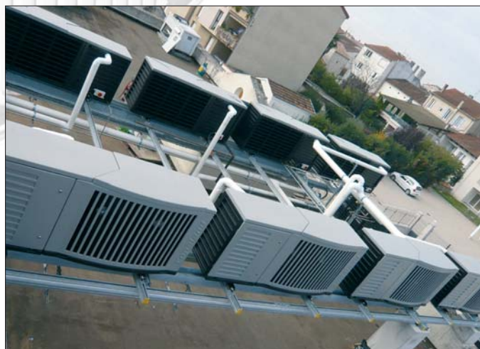
Groupe Plein Air en réseau : - un réseau moyenne température, - un réseau basse température
