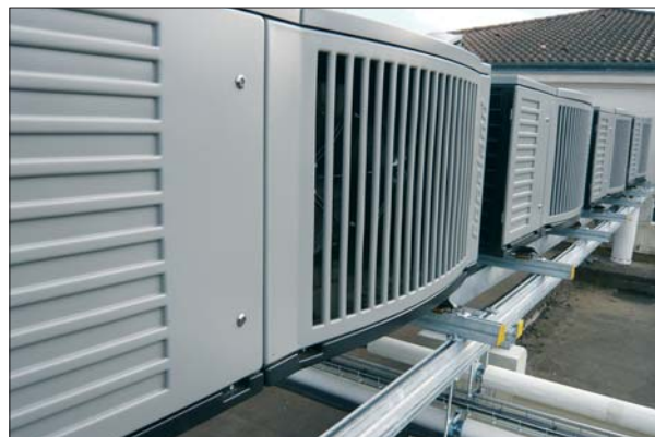
Groupe monté en réseau à l'hôpital de Villeneuve sur Lot
