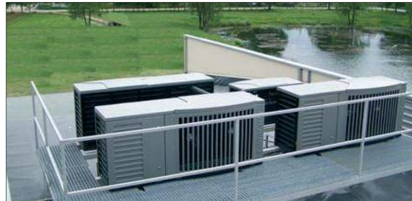
Groupes en réseau installés à Vilnius en Lituanie
