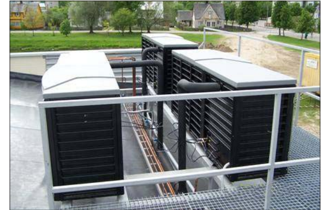
Groupes en réseau installés à Vilnius en Lituanie
