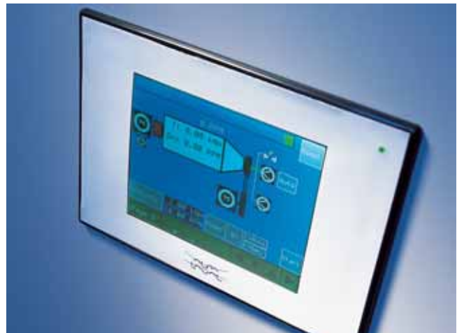
Écran du Contrôleur central du décanteur (DCC)
