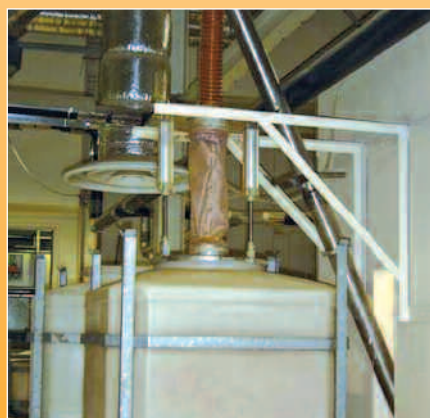
Station de remplissage confinée
