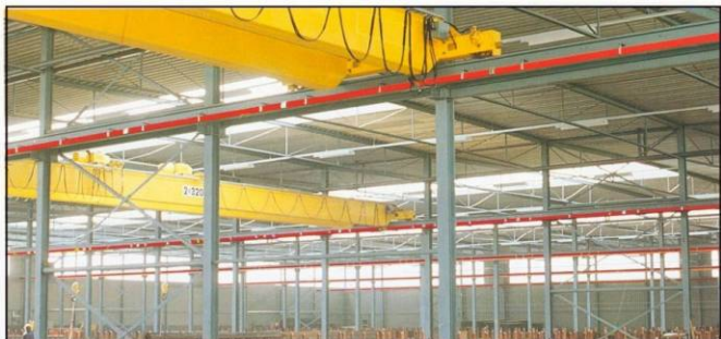
1 Des ponts routiers dans un parc à fer. 5 installations 50 ampères.
