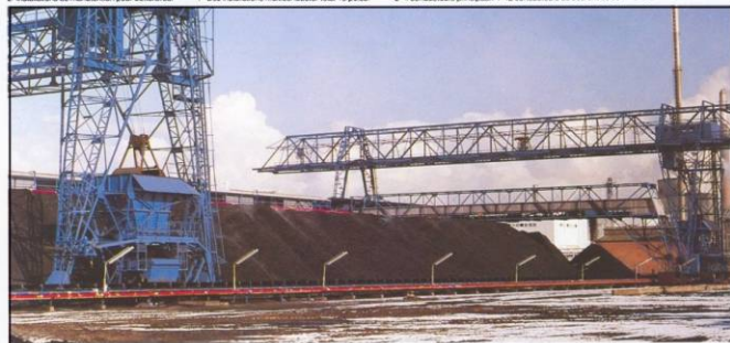
4 Installation de manutention de charbon dans une centrale électrique. Atmosphères de travail chimiques agressives et très poussiéreuses le a. poussières de charbon.
