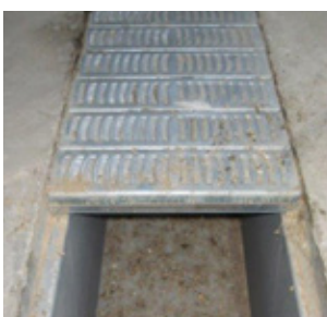
Lames ventilées sur caniveaux béton
