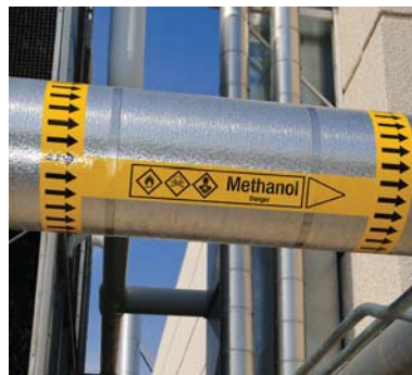
Marquage de tuyauteries
