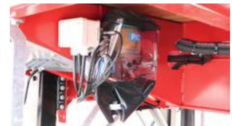
Graissage centralisé avec 2 pompes BEKAMAX (Pico) avec graisse normale NLGI-2 avec protection amovible autour de la pompe.
