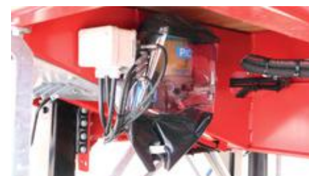
Graissage centralisé avec 2 pompes BEKAMAX (Pico) avec graisse normale NLGI-2 avec protection amovible autour de la pompe.
