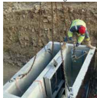
KSA dans regard
