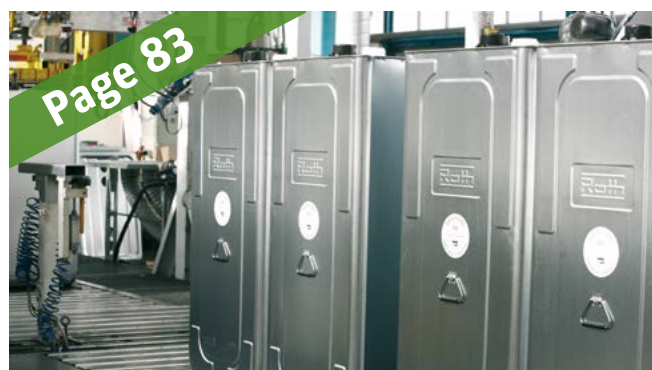
Cuves fioul, liquides dangereux et polluants ●
