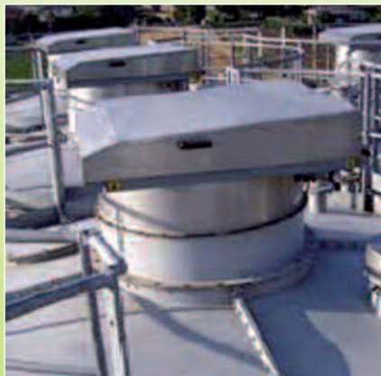
Filtre intégré dans le silo
